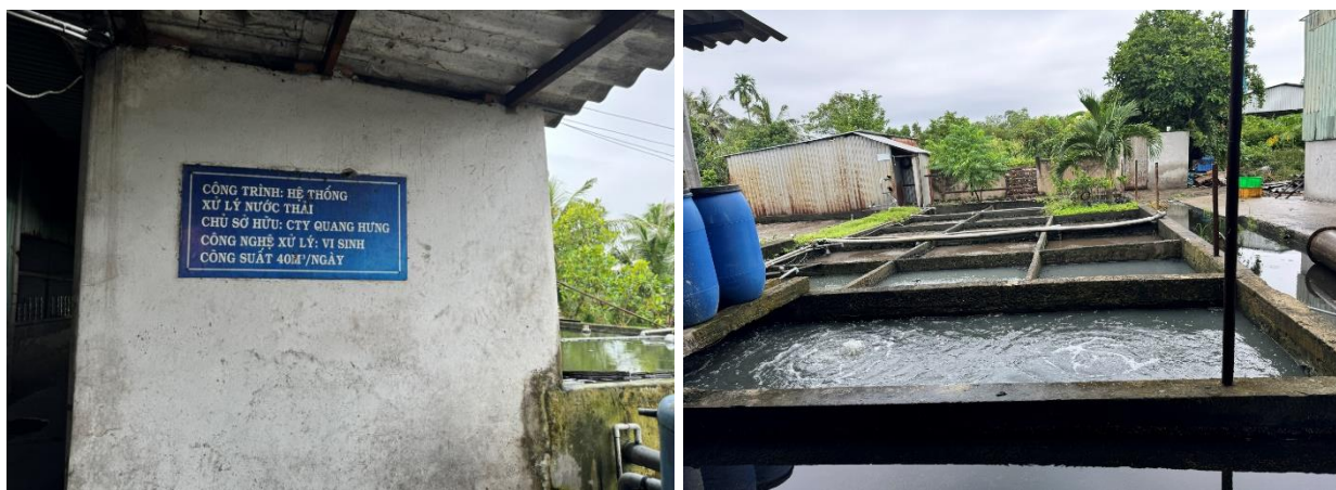
Hình 9. Hệ thống xử lý nước thải tại nhà máy
